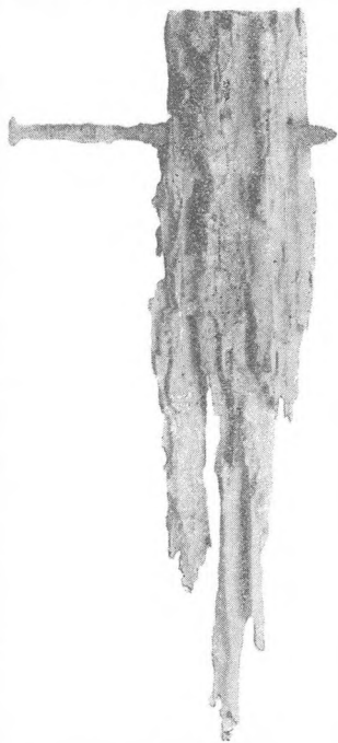
Рис. 4. Кусок дерева из чердачного перекрытия дома, поврежденного термитами. Одесса.
